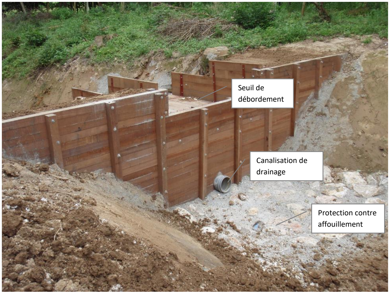
Barrage en bois avant mise en service, implanté dans un vallon
