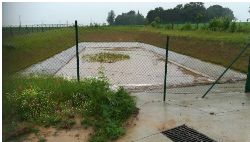
Bassin de rétention en béton, destiné à intercepter du ruissellement du voirie et du ruissellement agricole avant un village.
