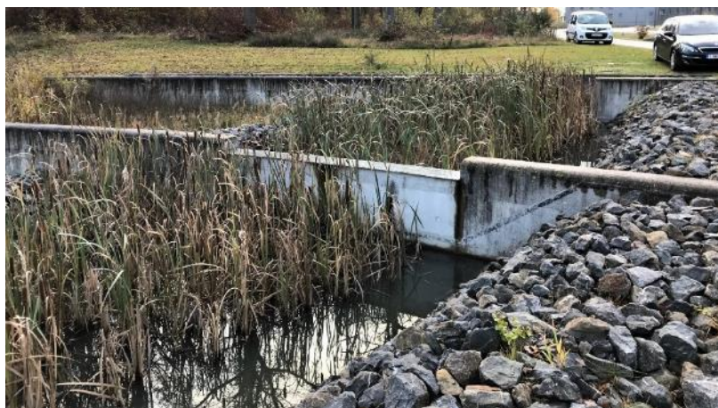
Bassin de rétention empierré, végétalisé, conçu pour temporiser les eaux issues d'une zone d'activités commerciales.
