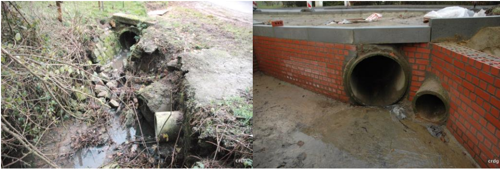
Afbeelding 28: Herstelling van beschadigde kunstwerken op de beek Gobertange in Geldenaken (foto voor en na) (Bron: Contrat de rivière Dyle-Gette asbl)
