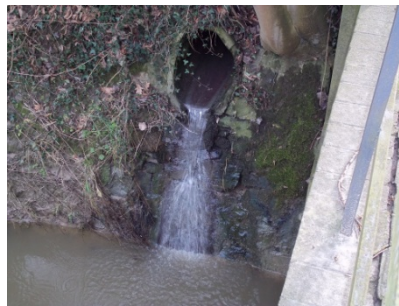
Isières - Rejet de l'égout communal dans la Sille
