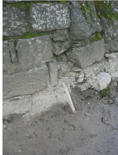
Figure 6: tuyau visible à proximité de la zone
