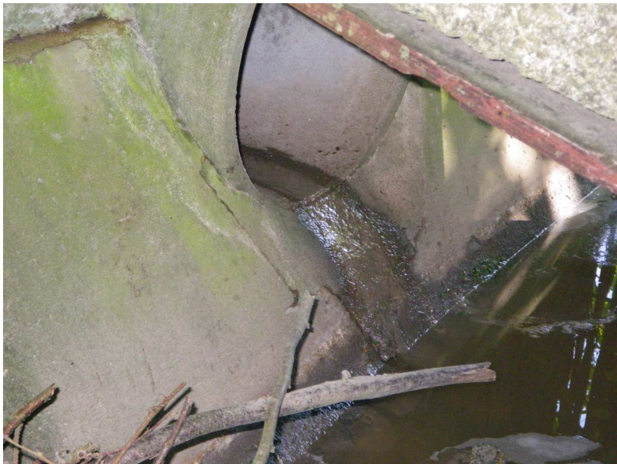
Figure 55: Déversoir d'orage de Gendron
