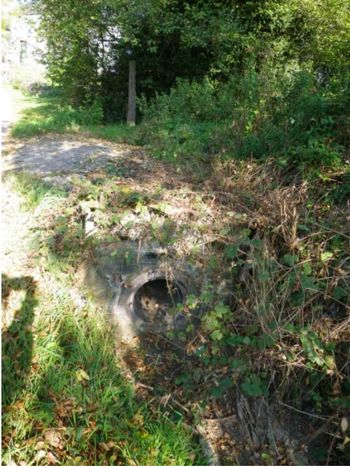
Figure 62 : DO 16 relevé sur le terrain le 12/10/2010.
