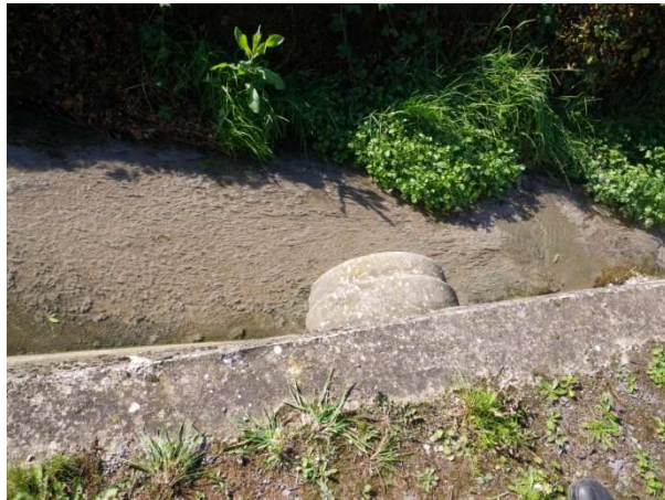
Figure 56 : DO 4 relevé sur le terrain le 12/10/2010.
