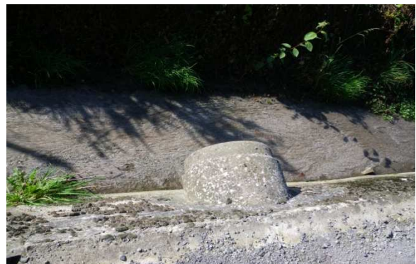
Figure 57 : DO 5 relevé sur le terrain le 12/10/2010.
