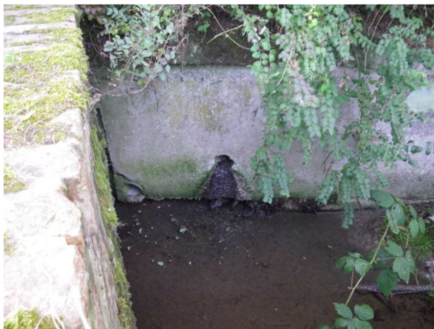
Figure 35 : déversement d'eaux usées en provenance d'une habitation isolée.
