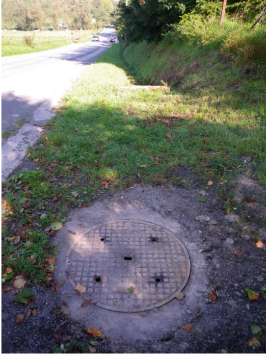
Figure 58 : DO 10 relevé sur le terrain le 12/10/2010.
