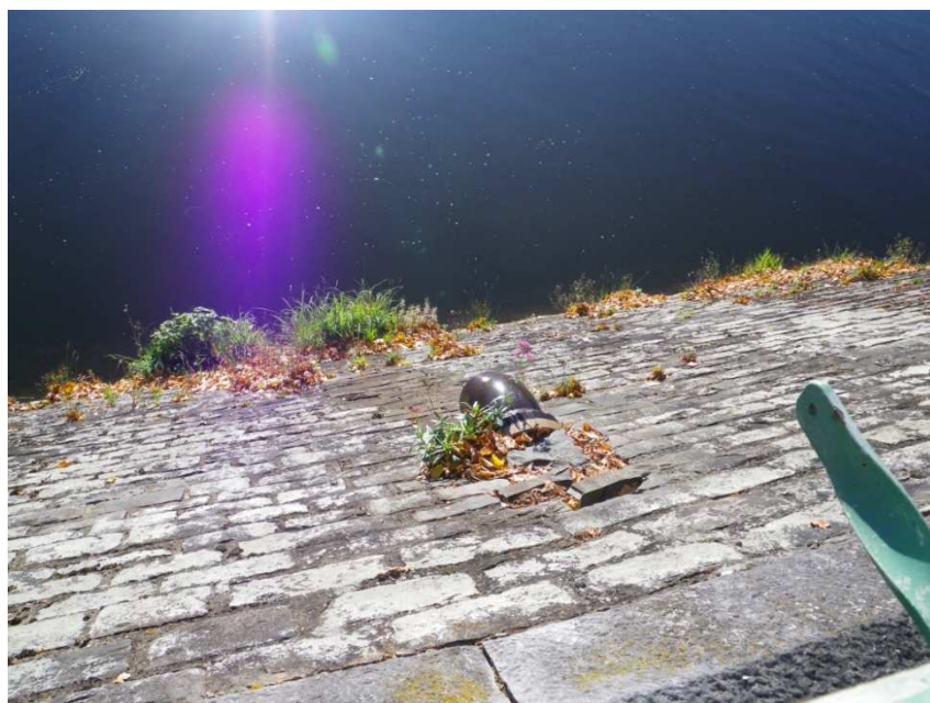
Figure 40: rejet d'eaux de ruissellement dans la Semois, à proximité de la zone de baignade
