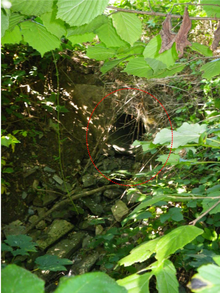
Figure 40: rejet d'eaux usées dans la Semois, rue du Bravy
