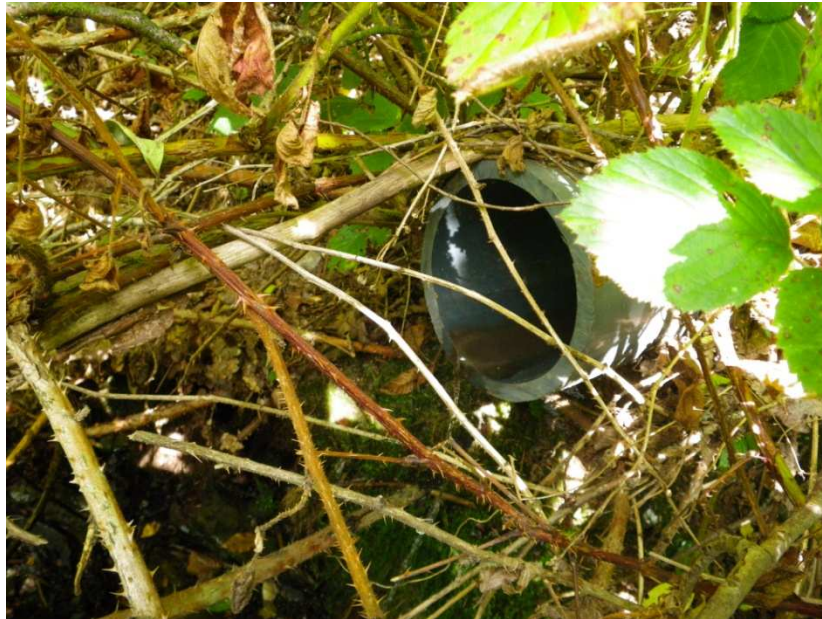
Figure 40 : rejet des eaux traitées provenant de la STEP du camping de la Foulerie (photographie prise le 07/09/10).
