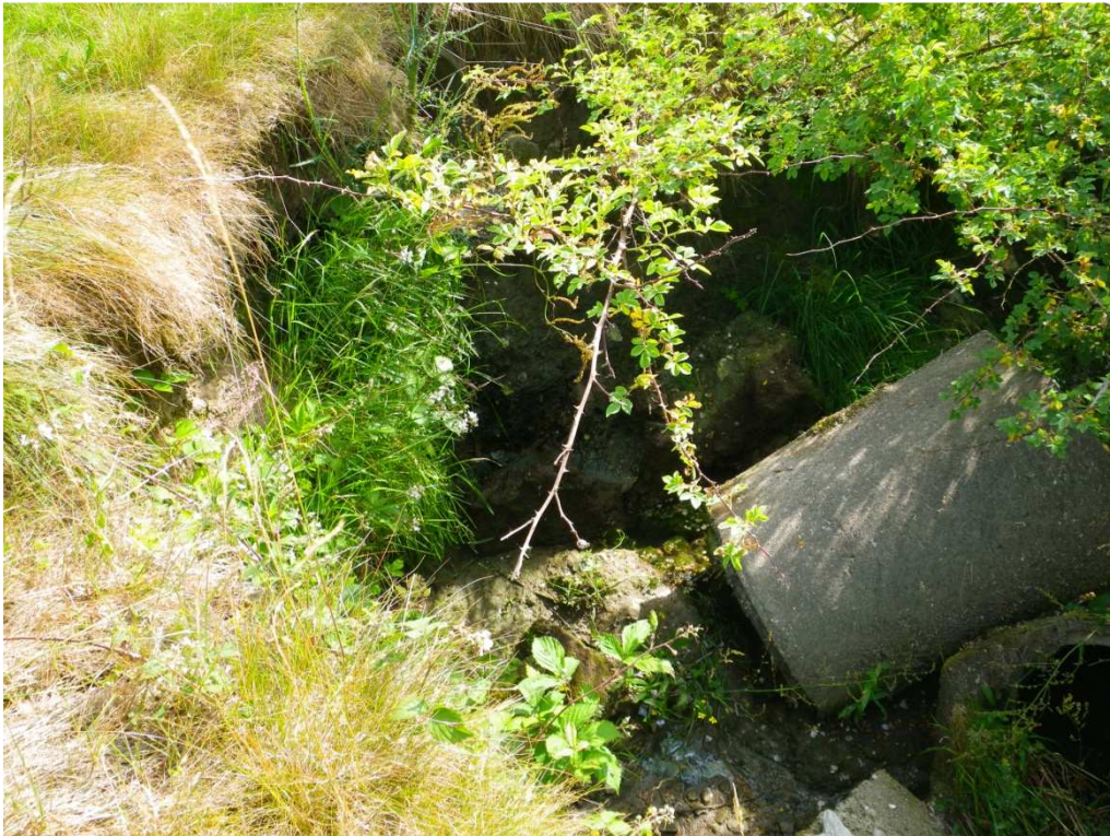
Figure 43: rejet du déversoir d'orage à Hamipré
