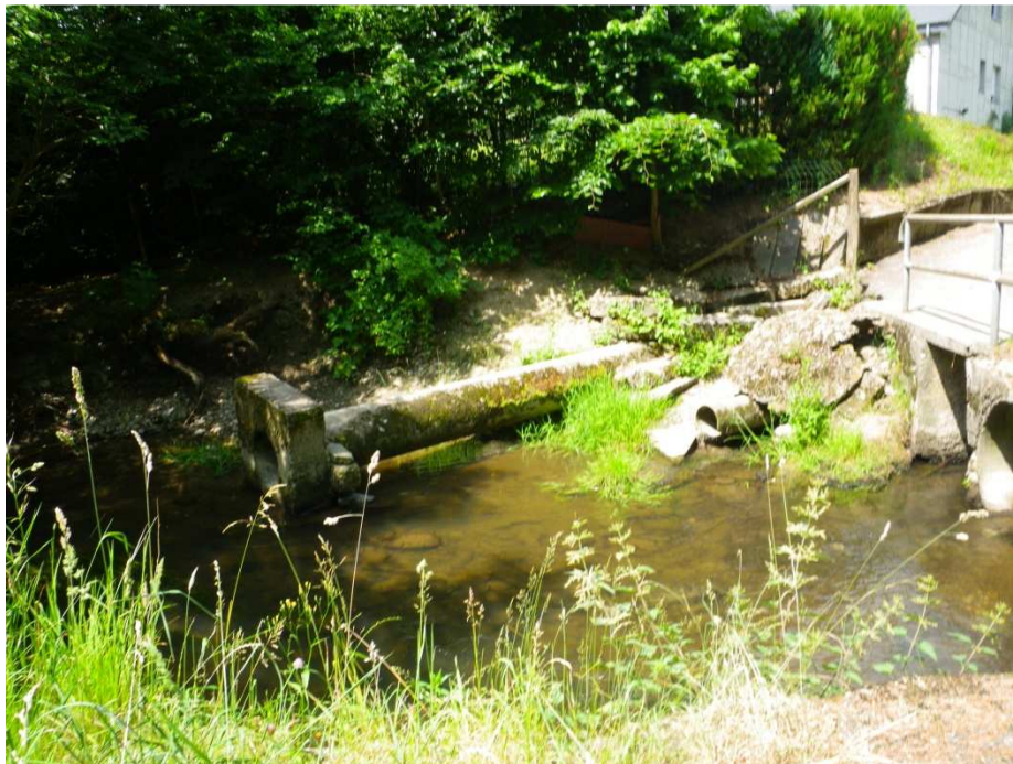
Figure 44: rejet du déversoir d'orage du lieu-dit « la Chaumô »
