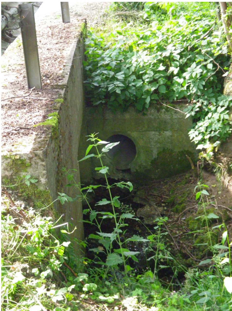
Figure 15: rejet d'eaux de ruissellement dans le ruisseau d'Ospot
