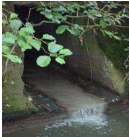
Figure 5: rejet constaté en rive droite de l'Amblève qui explique le pic de concentration en EI. Source des données: Contrat de Rivière de l'Amblève, 2013.
