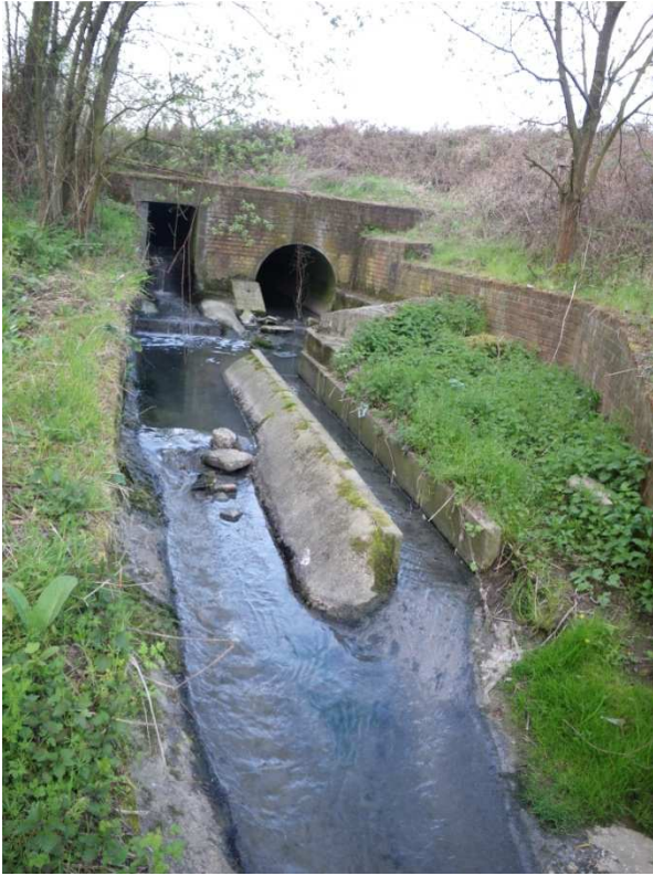
Figure 6: rejet d'eaux usées dans le ruisseau
