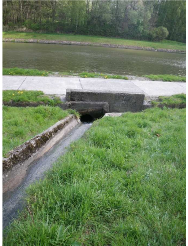
Figure 7: exutoire dans le canal (confluence du ruisseau)
