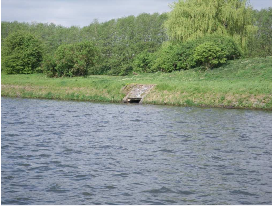
Figure 40: rejet d'eaux usées dans le canal –partie centre de la zone amont de la zone de baignade E03
