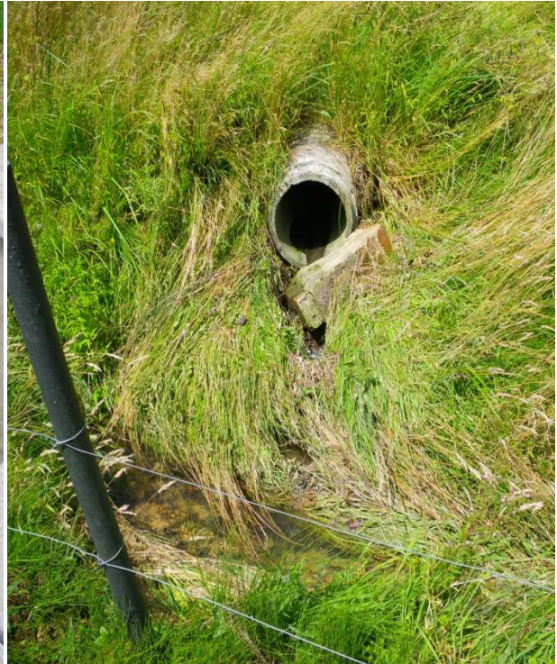
Figure 32 : déversement d'eaux usées dans le ruisseau d'Erpion.
