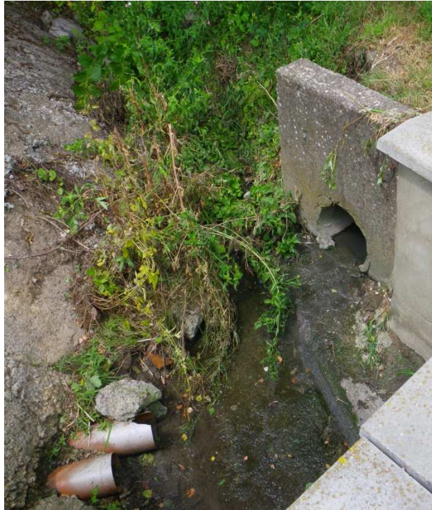
Figure 31 : déversement d'eaux usées dans le ruisseau de la Fontaine.
