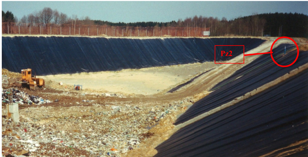
Figure 11 : C.E.T. de Morialmé : Localisation du Pz2, détruit en 2013 lors des travaux de réhabilitation
