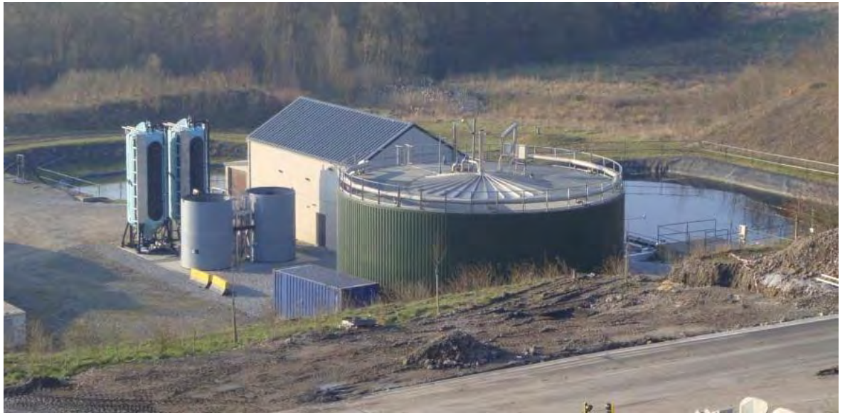
Figure 3: Vue de la STEP
