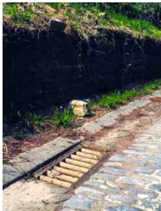
Photo 18. Avaloir d'eau pluviale, bordure (heureusement ici peu élevée) et mur de soutènement le long d'une route... bien des obstacles pour les batraciens ! © C. et N. Percsy
