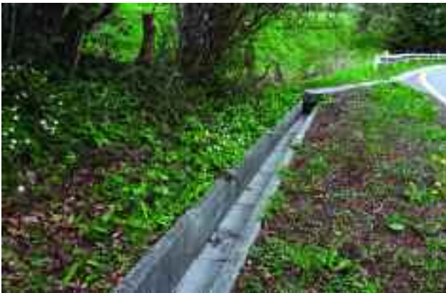
Photo 24. Canal en U parallèle à la route conduisant les batraciens vers un passage souterrain ou un crapauduc - © C. et N. Percsy
