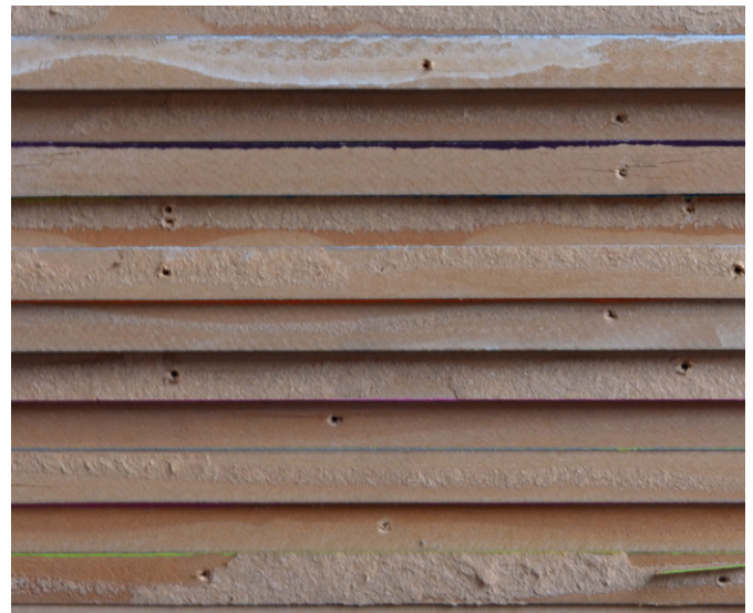
Les panneaux après démantèlement. Les traces de clous et de MDF collé sur la tranche, RN.
