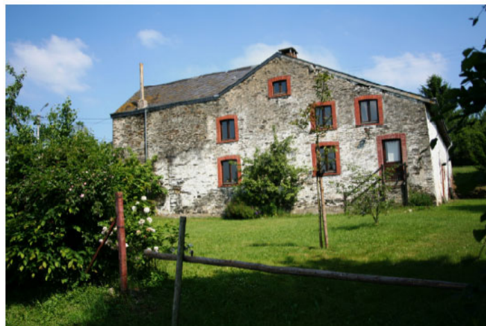
Herlinval (La Roche-en-Ardenne). Ancienne ferme avec encadrements en briques aux fenêtres et accès via pignon.
