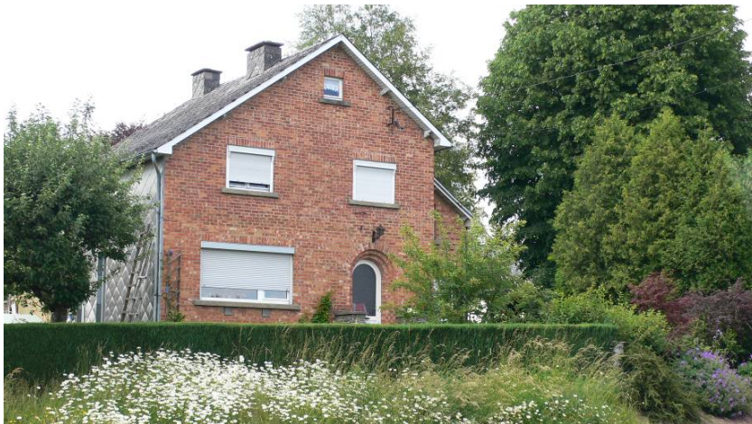
Gouvy : un bâtiment en briques trop rouges et relevant d'une typologie que l'on pourrait retrouver en Flandre, dans le Hainaut et dans le Brabant. Une typologie exogène, non identitaire, qui brise l'unité et la cohérence du paysage rural des Ardennes.
