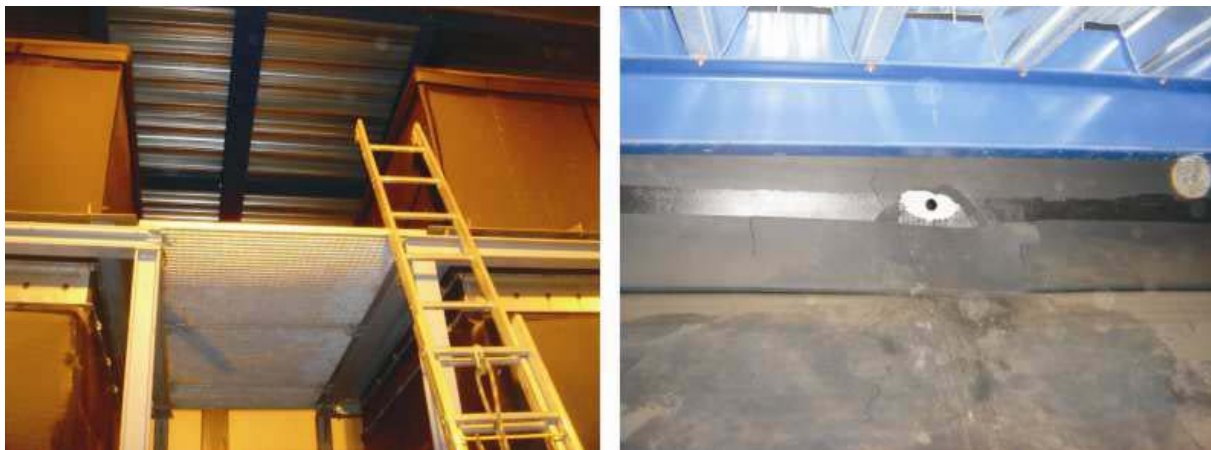
Figure 9 : Point de prélèvement sous toiture dans la cheminée centrale du sécheur de boues.
