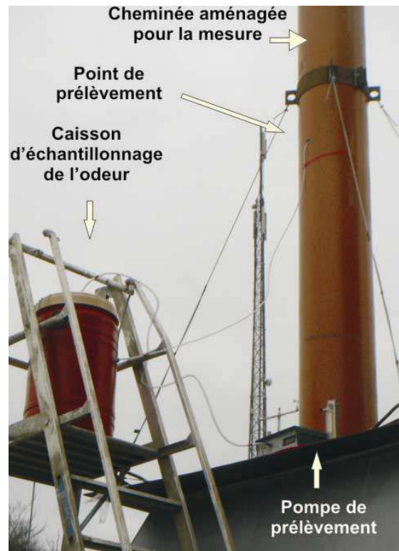
Figure 10 : Dispositif aménagé au-dessus de la cheminée centrale du sécheur de boues pour mesurer le débit d'odeur dans des conditions de flux laminaire.
