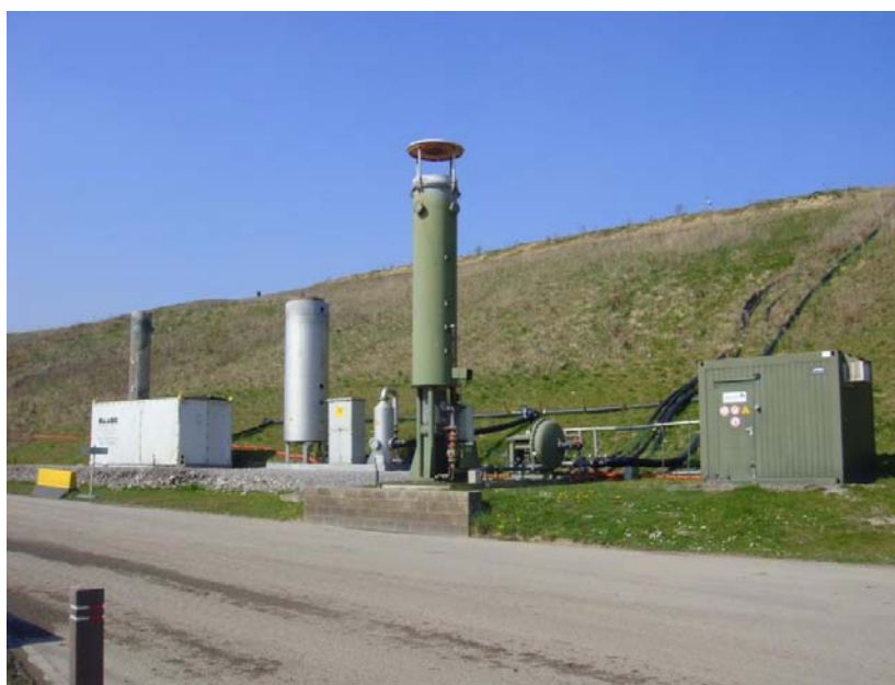
Figure 4: Vue des torchères
